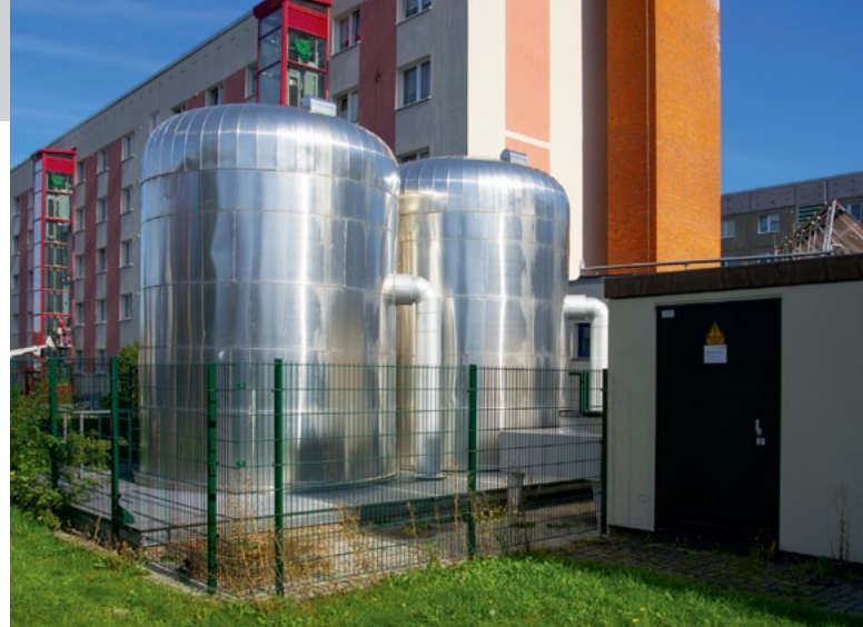
Eines der modernen Heizwerke der Stadtwerke befindet sich in der Triniusstraße und ist mit zwei 50-Kubikmeter-Wasserspeichern ausgestattet, um den Heizbetrieb zu optimieren.
