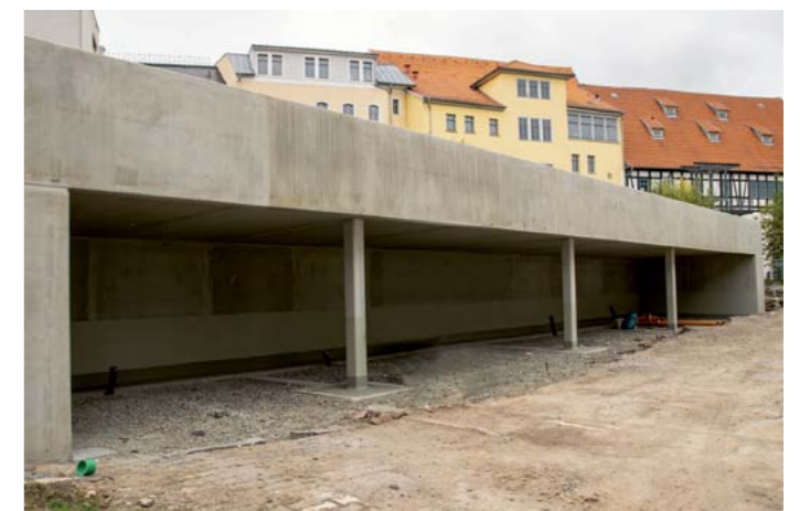
Der 43 Meter lange Baukörper des neuen Parkdecks hinter dem Gebäude ist bereits fertiggestellt worden.
