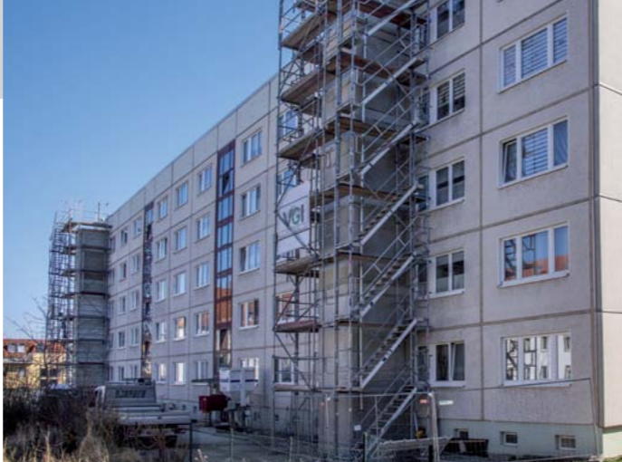
Im April 2022 waren die beiden Fahrstuhlschächte in der Goethestraße 5 und 5c weitestgehend fertiggestellt.
